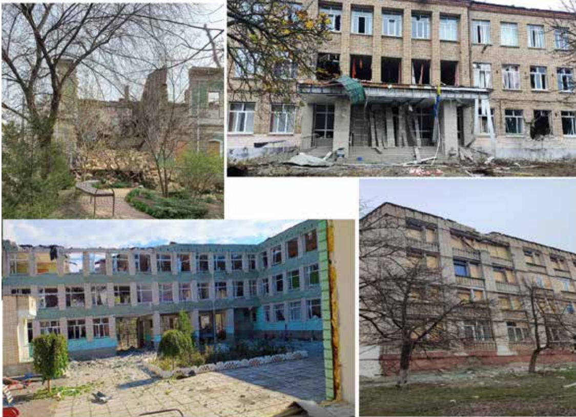
Рис. 6. Фасади найбільш пошкоджених шкіл у м. Херсон
